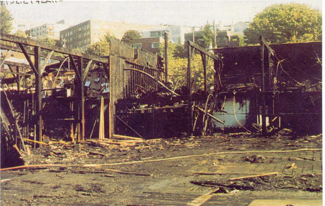
Blackstock kereste deposu yangınında çatı çökmüřtür, bununla beraber bazı iç bölmelerin bir kısmı ağır řekilde hasara uğrarken bazıları ayakta kalmıřtır.
